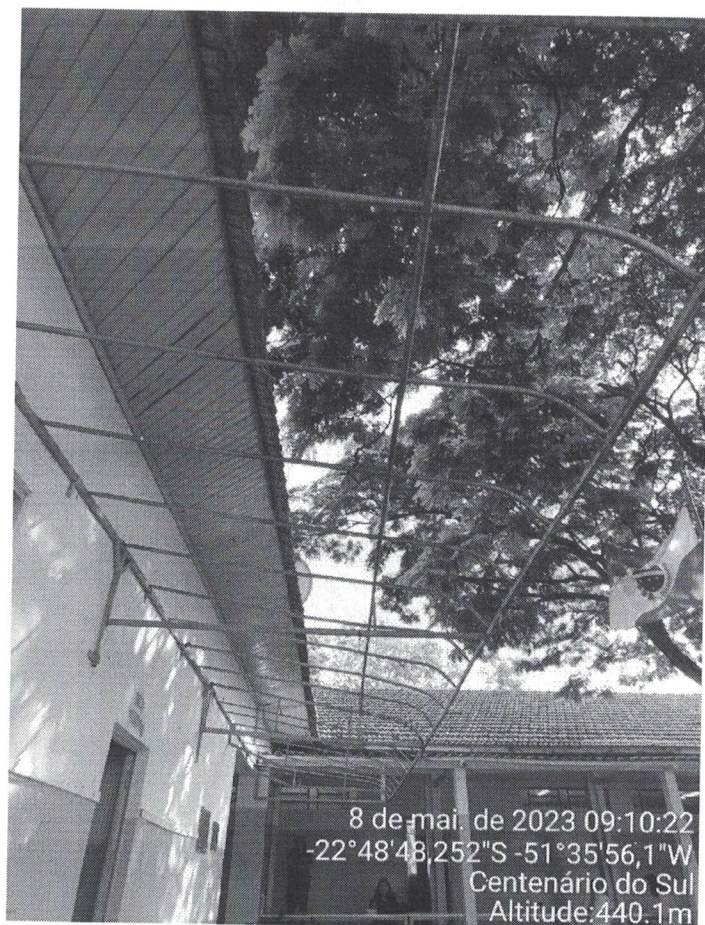
Imagem 6: Falta de lona de cobertura
